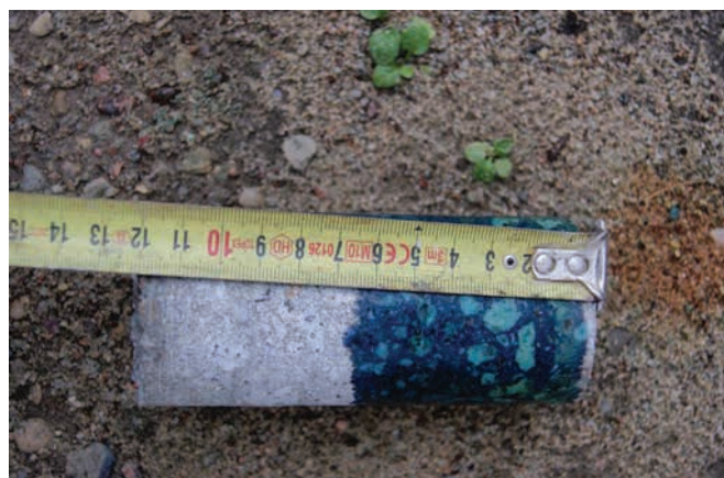
Fot. 5. Rdzeń poddany badaniu zasięgu karbonatyzacji odczynnikiem Rainbow test. Głębokość strefy zobojętniałej wynosi ok. 5 mm.
