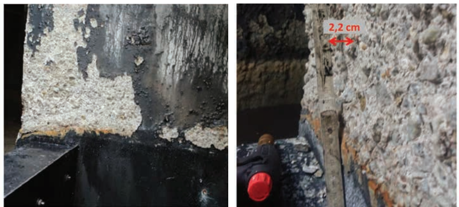
Rys. 5. Uszkodzone powierzchnie elementów zbiornika w obiekcie 02 Fig. 5. Damaged surfaces of the tank elements in the structure 02
