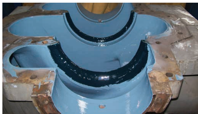
Fot. 7. Korpus pompy po odbudowie wżerów kompozytem Belzona®1311, modernizacji powłokowej Belzona®1341 i zabezpieczeniu przeciw kavitacji powłoką Belzona®2141
