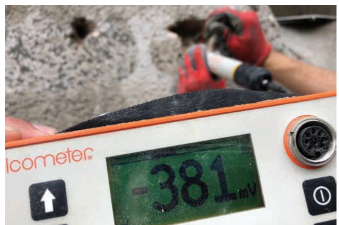
Fot. 7. Wynik pomiaru potencjału korozyjnego wskazujący na duże prawdopodobieństwo wystąpienia korozji.
