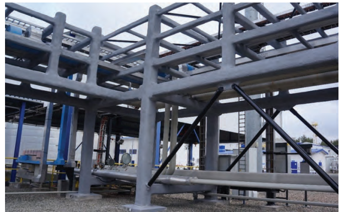
Fot. 4. Zabezpieczenie konstrukcji stalowej – kopalnia ropy i gazu (system FIRE-MIX)
