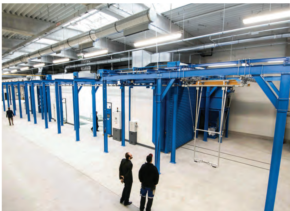
Linia do malowania ciekłego zakończona suszarką Infrared (IR)
