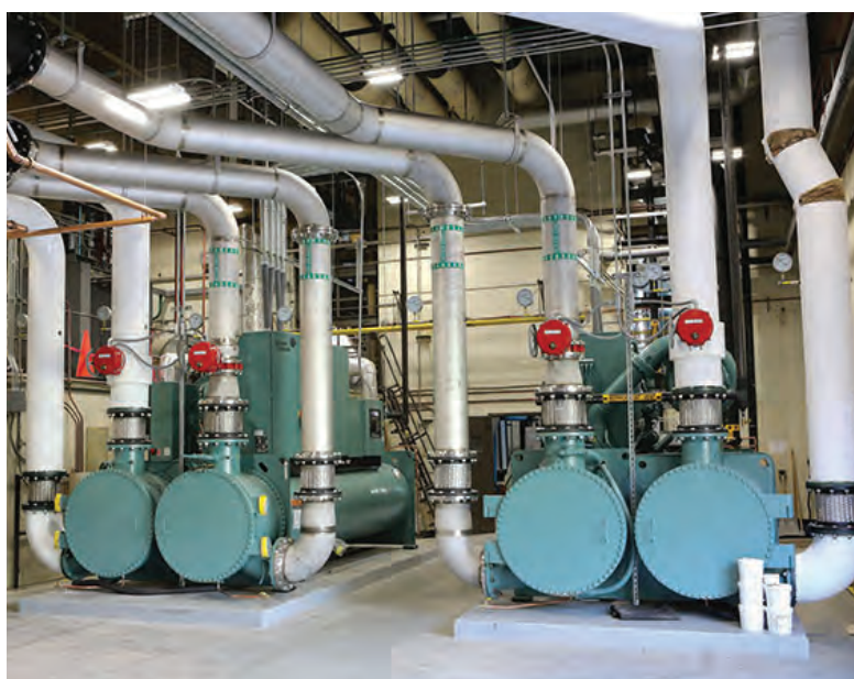
Fot. 1. Zespół wymienników chillerów systemu HVAC
