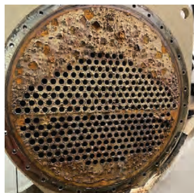
Fot. 2. Korozja dna sitowego wymiennika ciepła chillera
