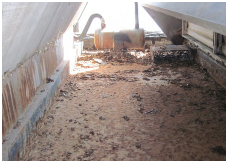
Fot. 7. Korozja wanny ociekowej wieży chłodniczej układu HVAC5811
