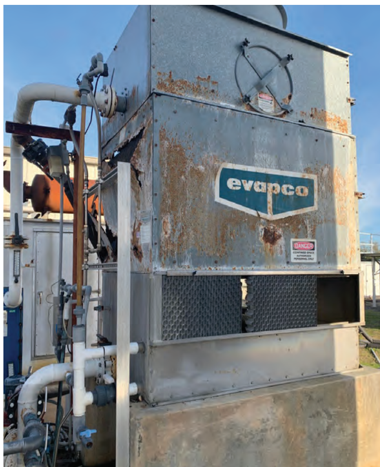
Fot. 5. Wieża chłodnicza z korozją blach poszycia
