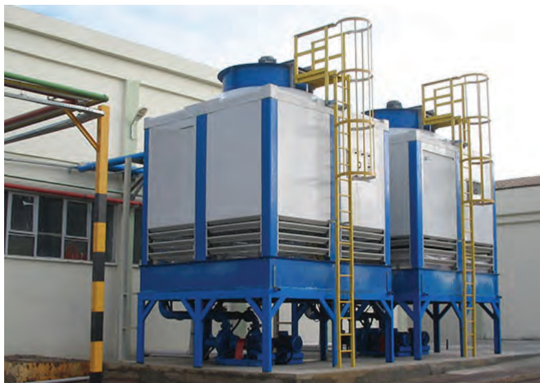
Fot. 6. Wieża chłodnicza układu HVAC
