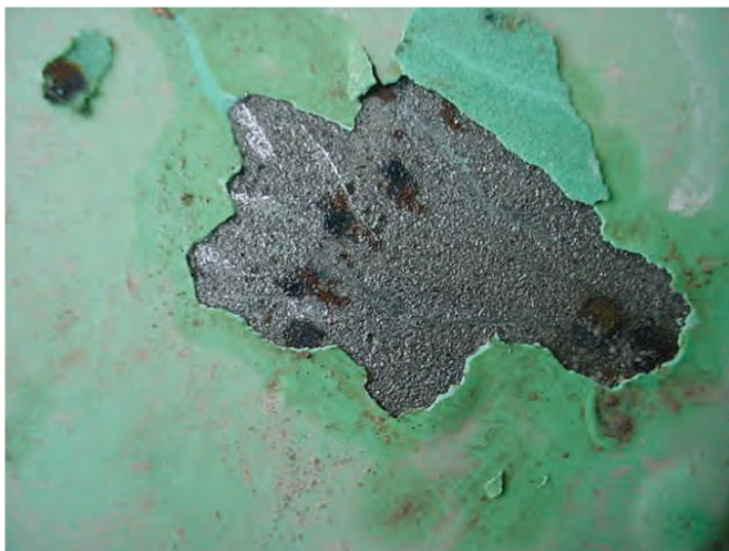
Rys. 19. Odspojenie i uszkodzenia powłoki FBE [30]
