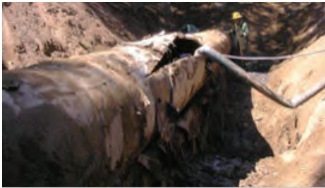
Rys. 17. Spowodowane przez korozję naprężeniową pęknięcie rurociągu (wyciek) podczas eksploatacyjnej próby hydrostatycznej [16]
