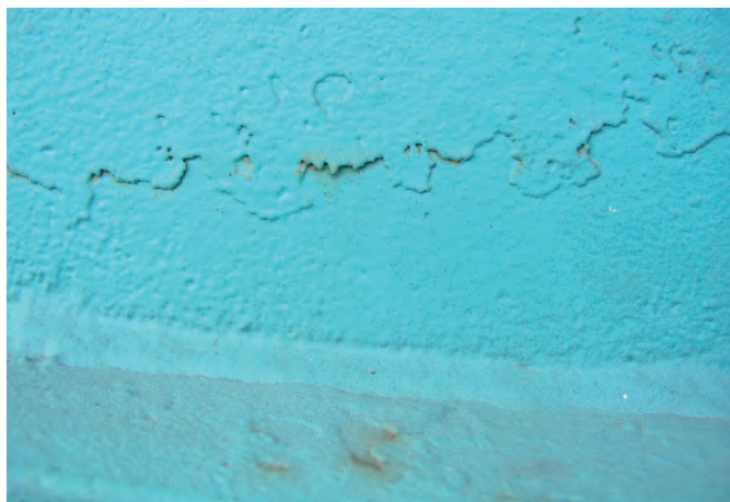
Fot. 4. Korozja szczelinowa na krawędzi niesfazowanej pozostawionej starej powłoki.
