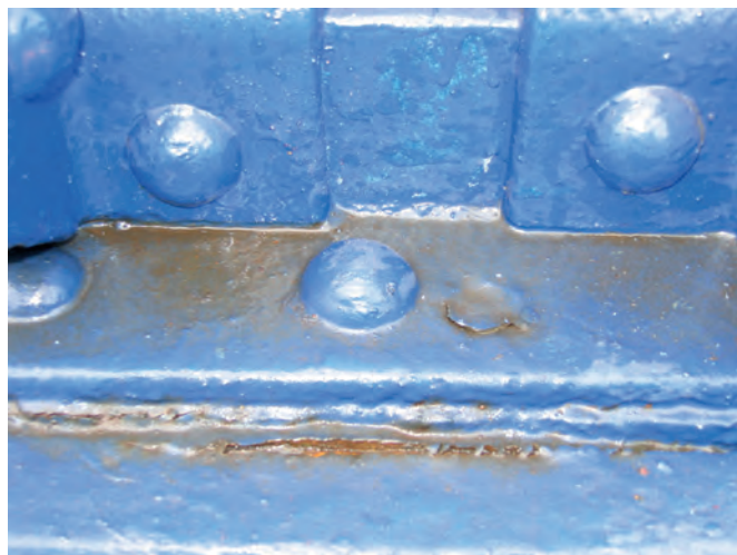
Fot. 11. Pęknięcie materiału i wpływ produktów korozji z „zalaną” farbą szczeliny.
