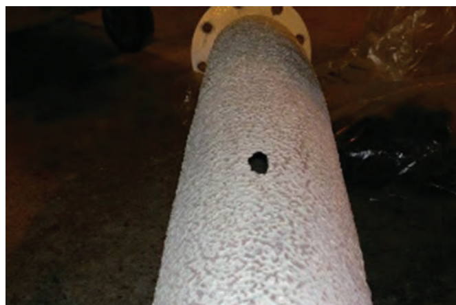
Fot. 4. Zużycie erozyjne z perforacją powierzchni kolana rurociągu
