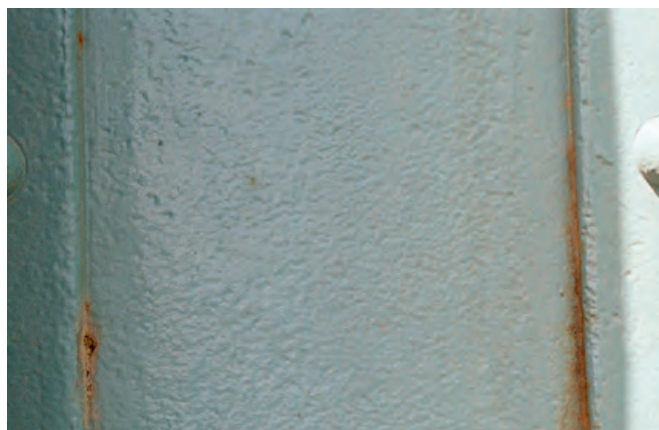
Fot. 3. Korozja szczelin po 1 miesiącu od wykonania renowacji.
