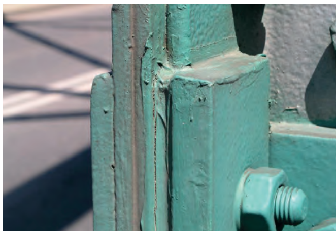
Fot. 10. Zabezpieczenie szczelin ekspansywną masą poliuretanową. Phot. 10. Crevices protection with expansive polyurethane mass.
