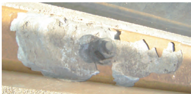
Fot. 5. Delaminacja powłok i korozja szczelinowa rozwijająca się od uszkodzenia mechanicznego powstałego podczas dokręcania śruby na powierzchni stalowej zabezpieczonej systemem duplex.
