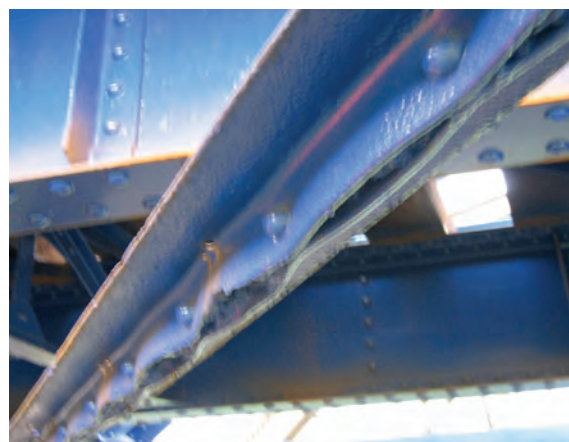
Fot. 1, 2. Wygięcie blach spowodowane korozją szczelinową.
