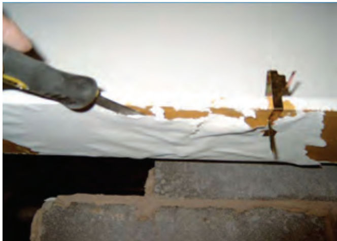
Fot. 1. Zbyt wysoka wilgotność podczas nakładania i utwardzania powłoki pęczniającej
