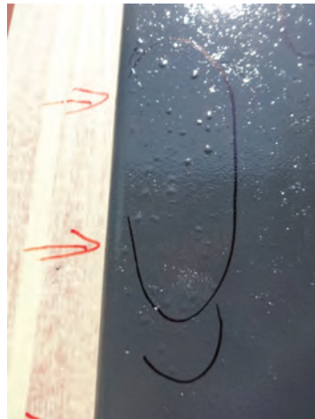
Fot. 2. Zbyt krótki czas przemalowania farbą nawierzchniową
