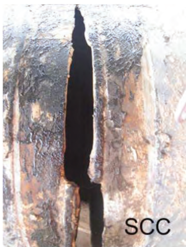
Rys. 12. Pęknięcie rurociągu pod powłoką taśmową w śladzie szczeliny podpowłokowej na zakładce taśmy [10]. Dzięki uprzejmości UKOPA
