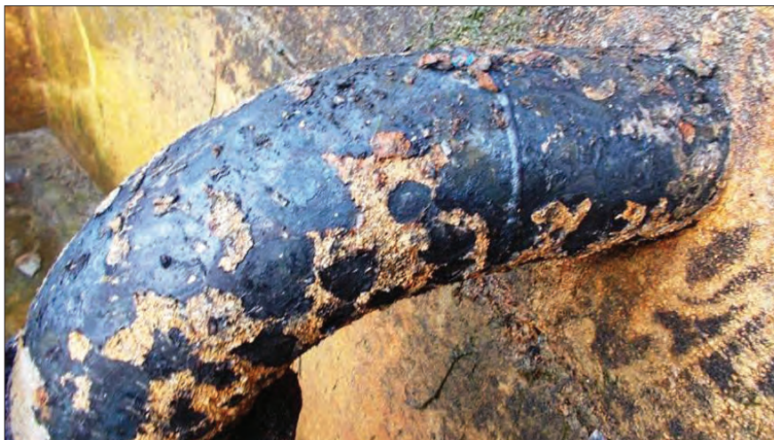
Fot. 1a. Kolano rurociągu stalowego mocno osłabione korozją
