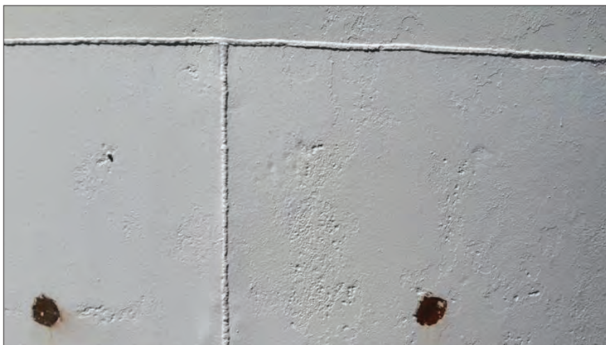
Fot. 1 b. Stalowy płaszcz zbiornika solanki z widocznymi głębokimi wżerami korozyjnymi
