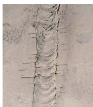
Rys. 6. Kolonia pęknięć przy prawie neutralnym pH w sąsiedztwie spoiny obwodowej [10]. Dzięki uprzejmości UKOPA
