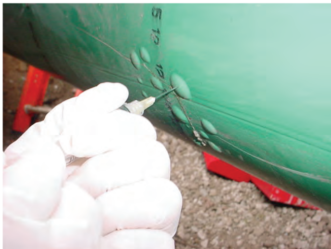
Rys. 14. Epoksydowa powłoka FBE z pęcherzami wypełnionymi elektrolitem o wysokim pH [30]. Dzięki uprzejmości Mehrooz Zamanzadeh (Dr Zee)
