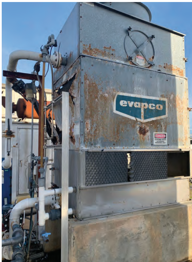
Fot. 3. Wieża chłodnicza z korozją blach poszycia
